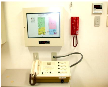
《緊急呼出し装置（事務所内）》
